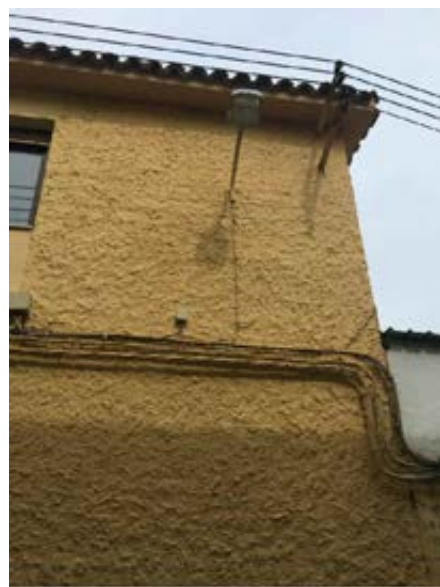
Vista actual luminarias alzado lateral 2
